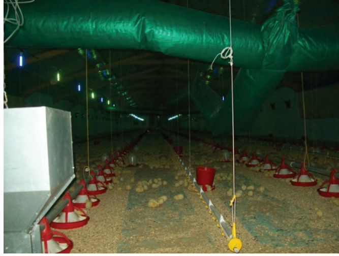
Şekil 8. Isınan havanın kümese branda borularla gönderilmesi
