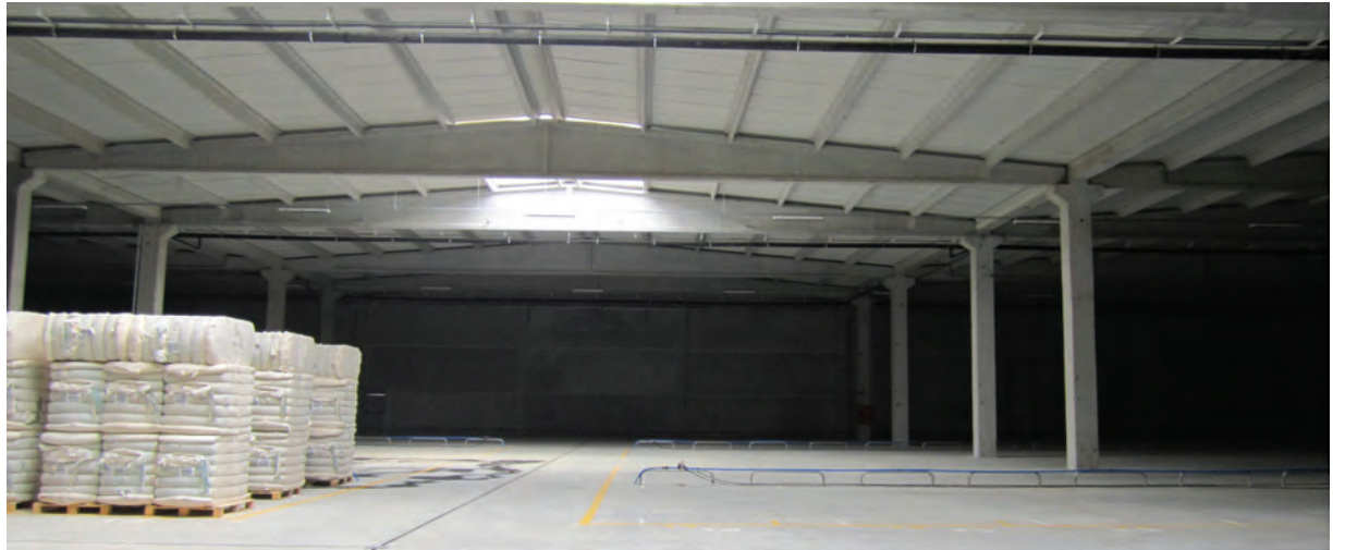
Resim 7. Pamuk Lisanslı Deposu Yangın Söndürme ve Nemlendirme Sistemi
